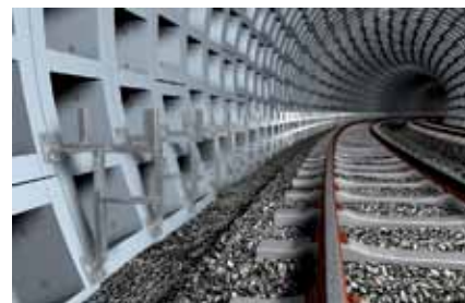
Installazioni in galleria
