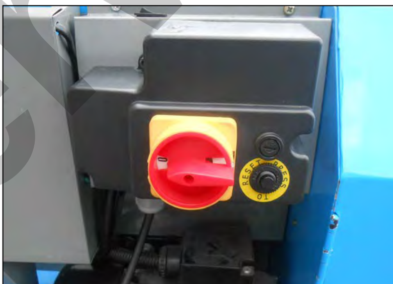
Figura 8 – Selettore generale e termica di protezione
