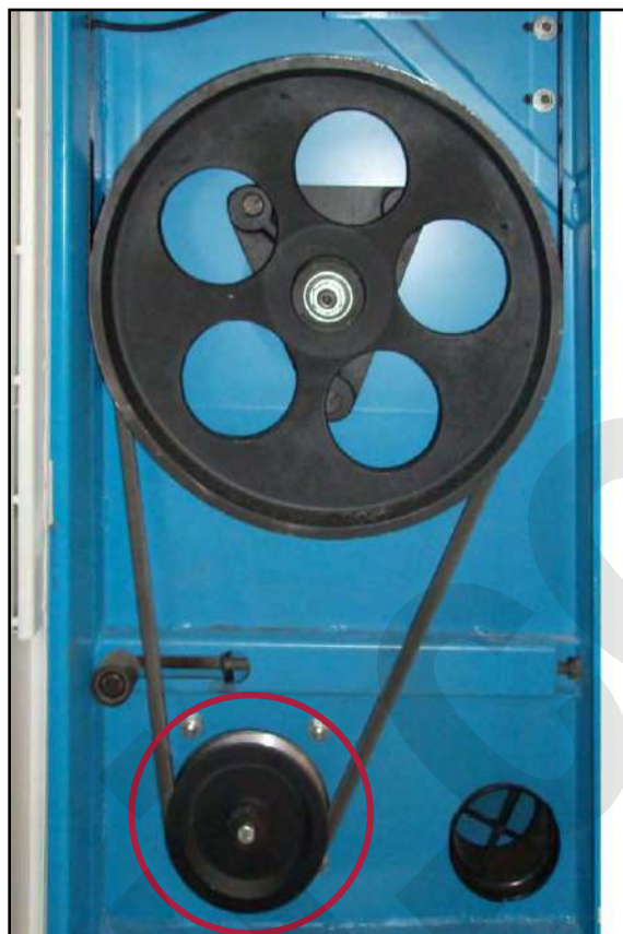
Figura 40 – Bulloni di fissaggio del motore elettrico.
