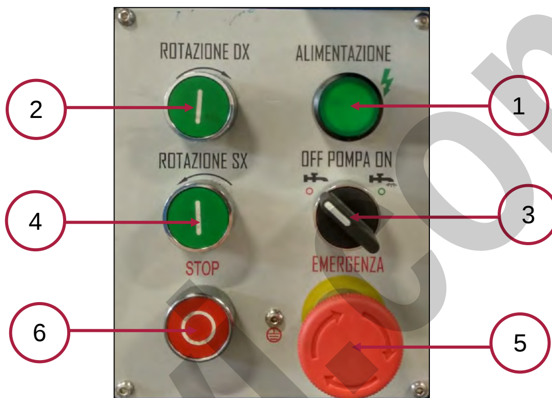
Figura 7 – Quadro di comando della macchina.
