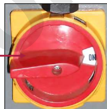
Figura 9 – Quadro di comando.
