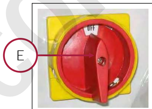
Figura 9 – Quadro di comando.
