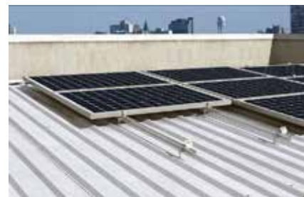
Impianto su copertura industriale
