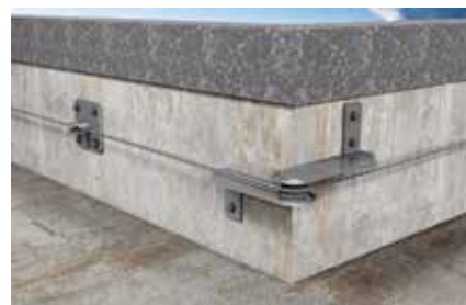
Linea flessibile verticale su parapetto di bordo
